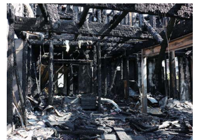
火災により全焼した住宅
