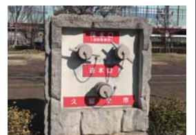
防火水槽には、採水口が設けられている所もあります。
